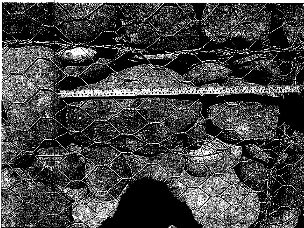
Fotografía N° 6. Bolones sobredimensionados en defensa fluvial de Catarpe
